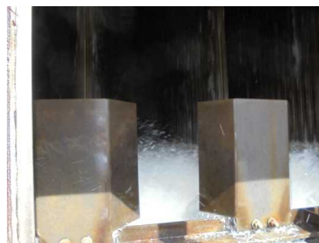
LNG 気化器の内部の様子
